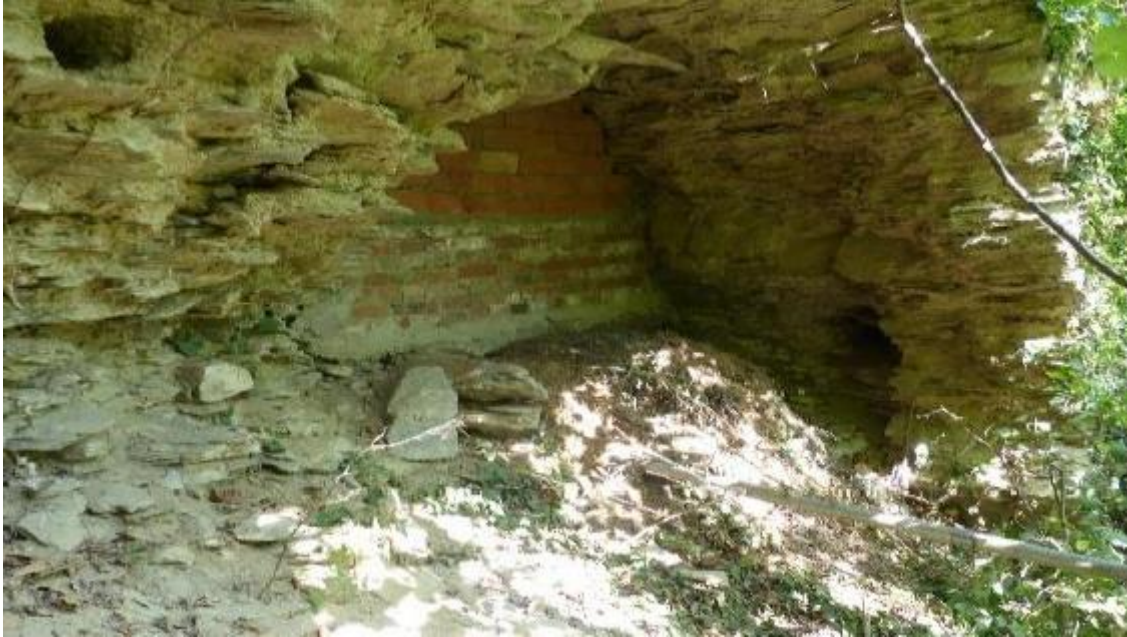
Ein verfallener Spitzbogen im Bereich des Fundaments schwächte die Statik der Schildmauer erheblich
